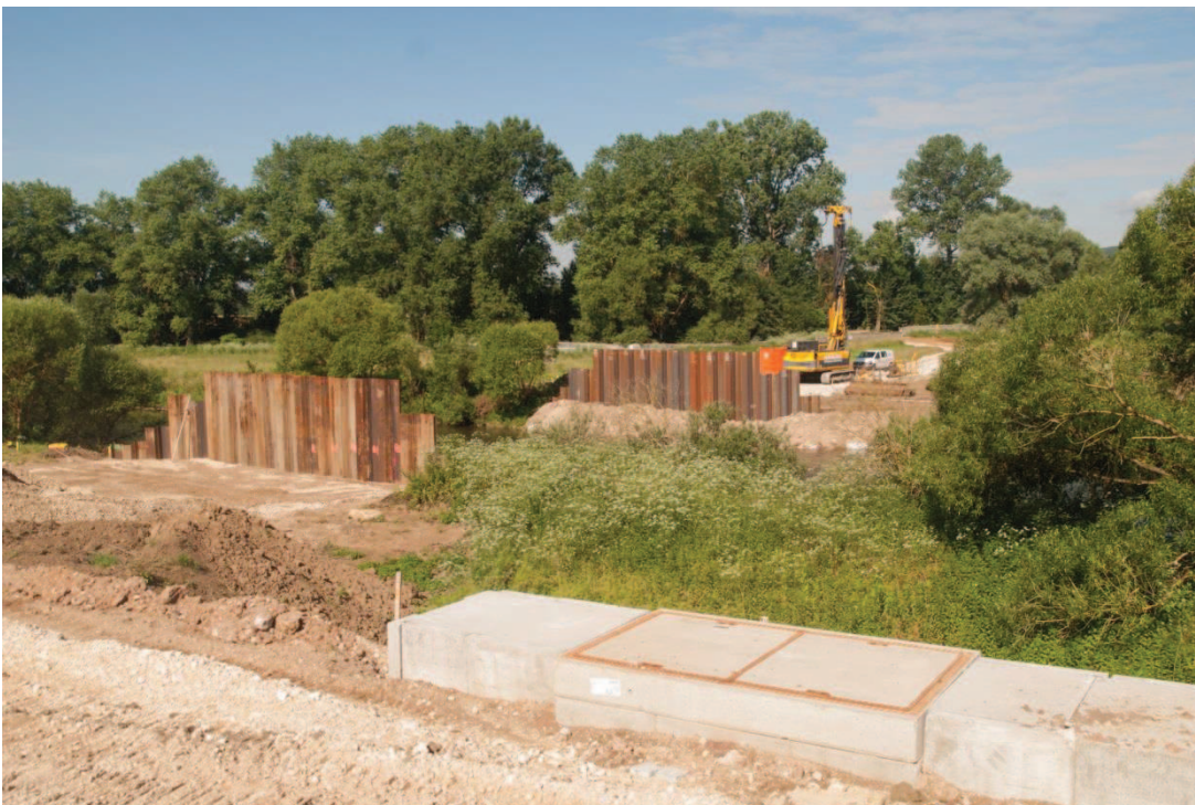
Südlich von Ebing laufen die Vorbereitungen für die Montage der Bauhilfsbrücke. Foto: Flussparadies Franken
